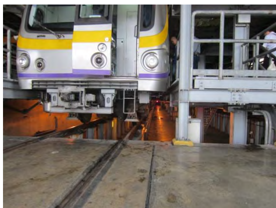
定期メンテナンス中
